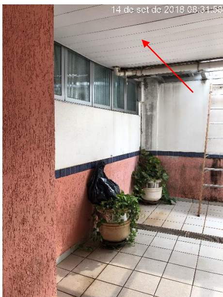
Foto 11: Local onde houve vazamento de água na copa.
