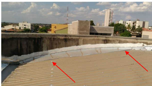
Foto 09: Detalhe dos locais de goteiras na Sala de Reunião do Gabinete do Prefeito.
