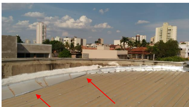
Foto 10: Detalhe dos locais de goteiras na Sala de Reunião do Gabinete do Prefeito.
