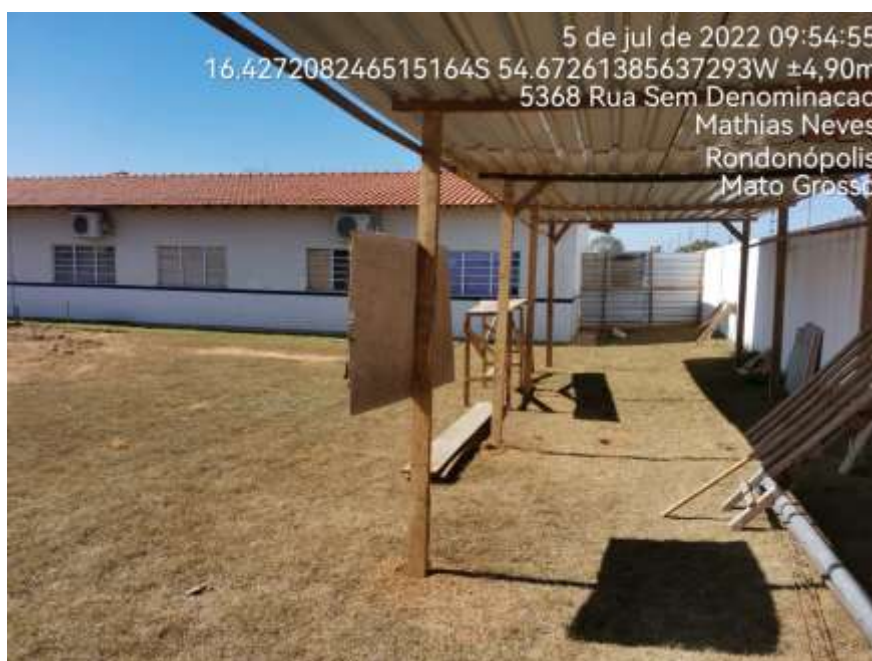
Imagem nº04 – Inexistência de Banheiro químico para os funcionários da obra.
