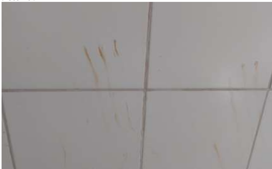
Imagem nº01 – Marcas de fezes nas paredes do banheiro masculino da unidade
