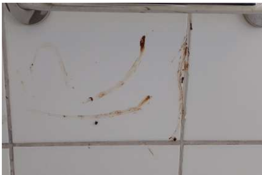
Imagem nº02 – Marcas de fezes nas paredes do banheiro masculino da unidade
